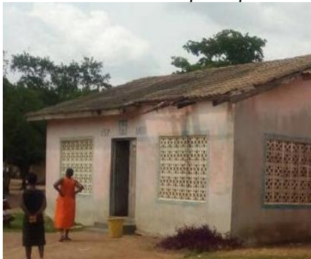
Photo n° 2 : Une Unité de Soins Périphériques délabrée à Payoka
